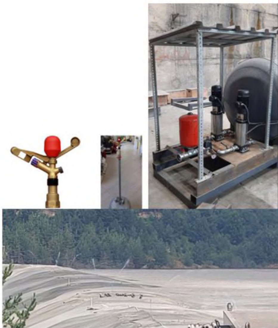
Slika 8.1. Rasprskivač i nosač rasprskivača koji su ugrađeni za potrebe orošavanja flotacijskog jalovišta (gore) i sistem za orošavanje u eksploataciji na flotacijskom jalovištu (dole)
